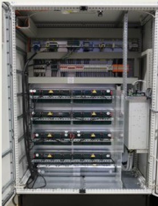
offener Schaltschrank mit Batterien
